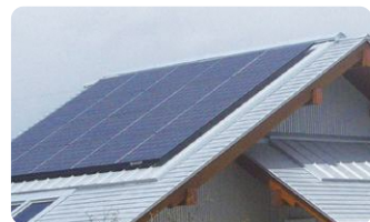
家の屋根に取り付けられた太陽光発電の設備
