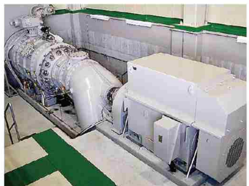
▲水車と発電機(浦山新発電所)
