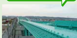
鋼橋の防食機能維持
