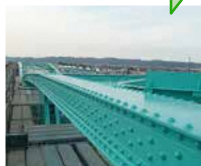
鋼橋の防食機能維持
