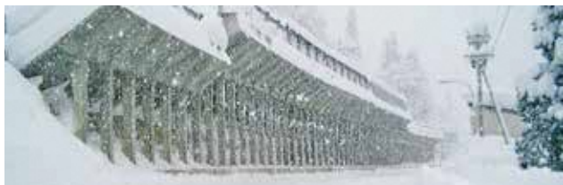
雪崩対策施設
