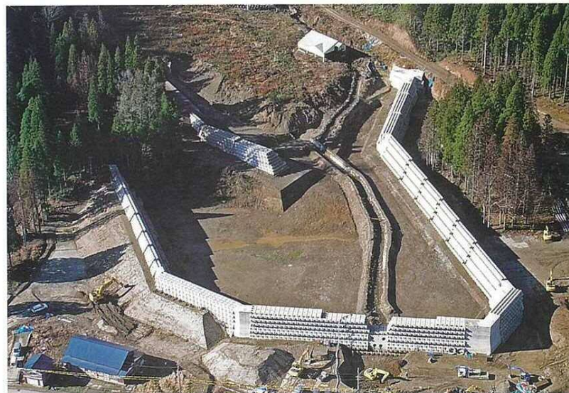
野原建設(株)施工の「神通川水系谷内谷災害関連緊急砂防堆積工 第4工区工事」
