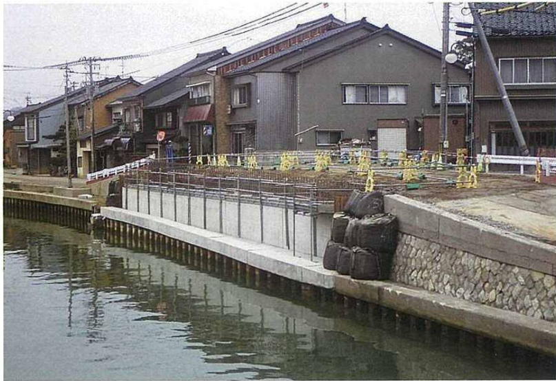
氷見土建工業(株)施工の「一般県道藪田下田子線道路総合交付金 (防災・架替)(北の橋)橋梁下部工その2工事」
