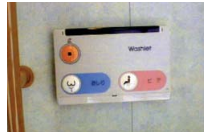
▲ 大きな操作盤 大きなスイッチは、見やすく押しやすいので便利です
