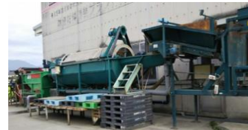
新水洗いシステム・乾燥システム
