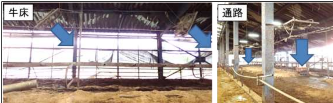
図4 牛床と通路に設置された換気扇
