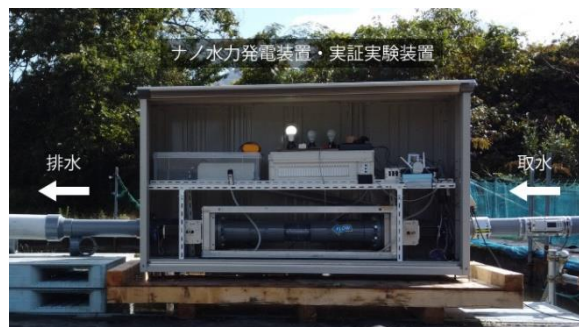
図 2-16 金沢工業大学等が実証しているナノ水力発電設備
