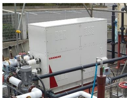
図 2-17 温泉排熱を利用した小型発電システム
