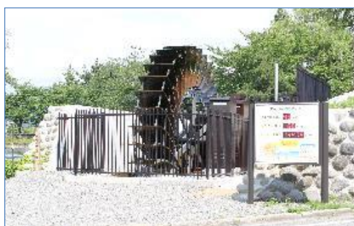
常西公園小水力発電所 [10kW] (富山市)
