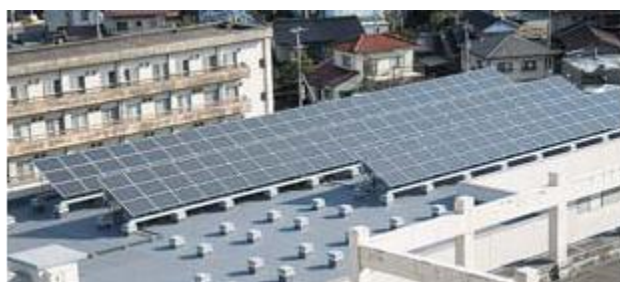
県立中央病院新東病棟 太陽光発電設備
