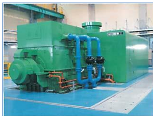
富山地区広域圏クリーンセンター蒸気タービン発電機
