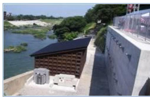
庄川合口発電所 [570kW] (砺波市)
