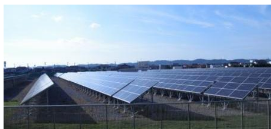
富山太陽光発電所
