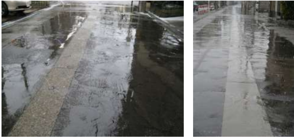
地下水を利用した消雪設備
