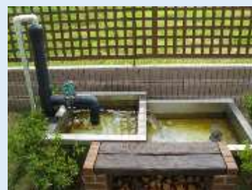
節水バルブを設置した自噴井戸
